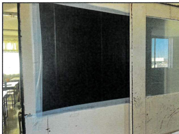
2-1のガラスが破損
